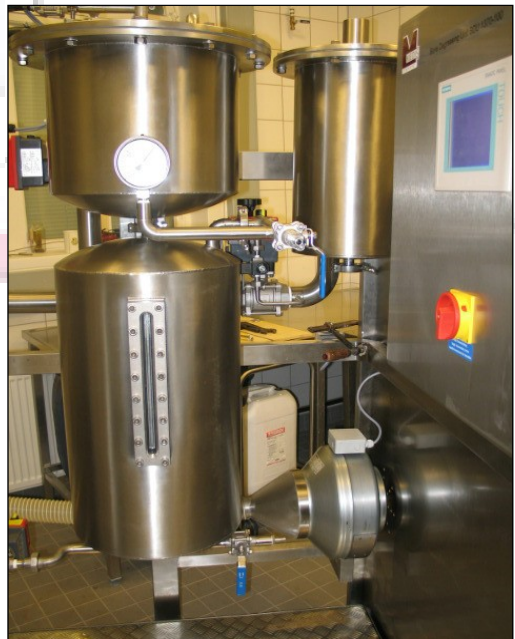
Dichlormethan-Rückgewinnungsanlage mit Kondensator und Vorratsbehälter
