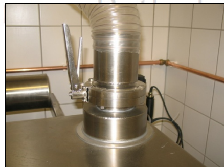
Abluftsystem über hauseigenen Ventilator
