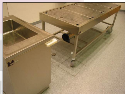
Abluftleitung vor der Verbindung mit der Andock-Station
